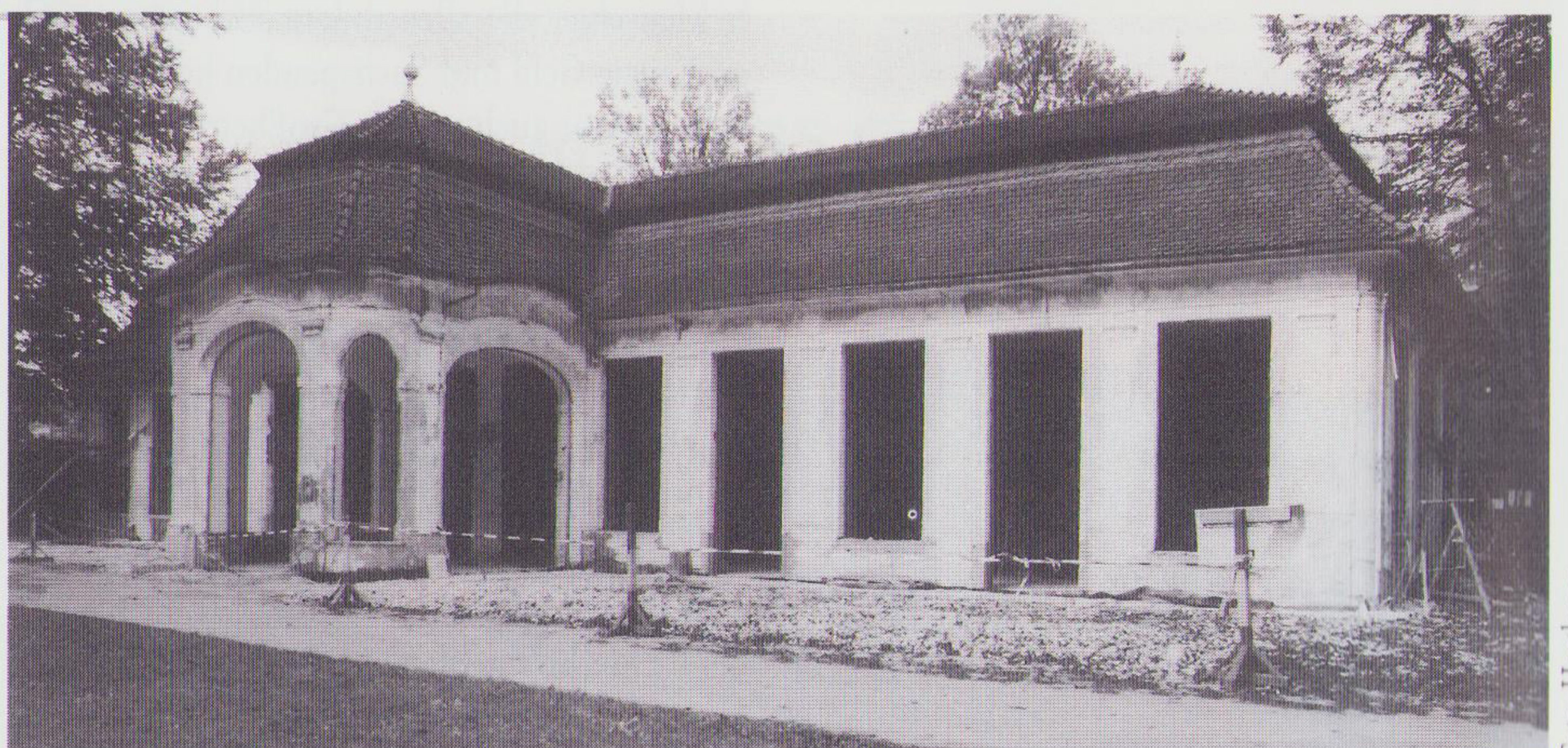
Die Stadt plant, das stark abgewitterte Dach des Schlosspark-Pavillons erneuern zu lassen. Die neuen Mieter haben bereits mit den Sanierungsarbeiten im Inneren des Gebäudes begonnen (Bild).
