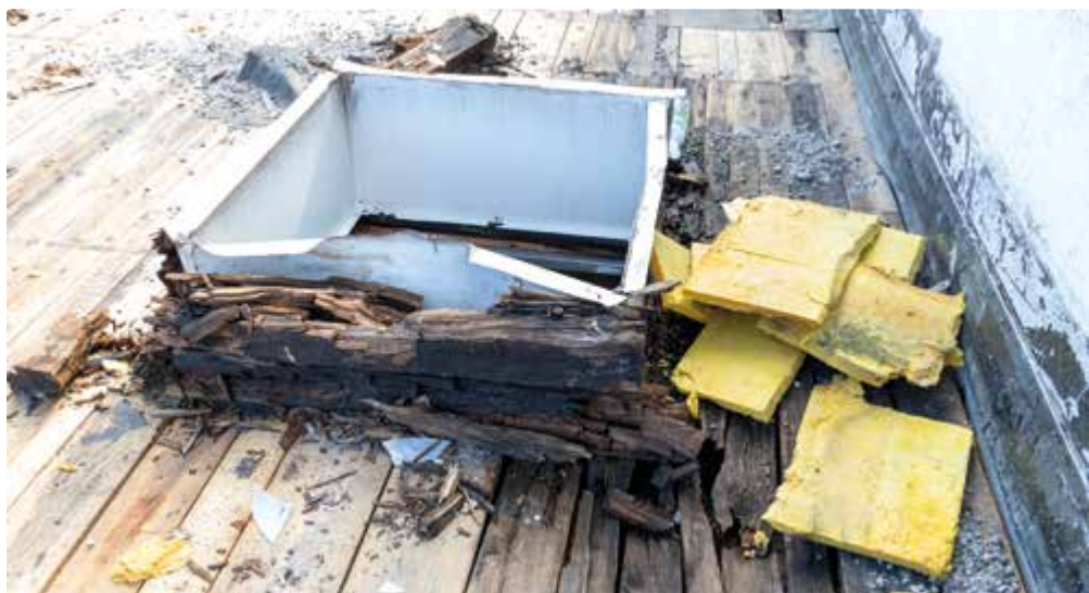
► Das alte Garderobendach mit schadhafter Lichtkuppel
