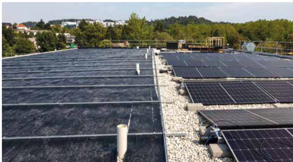
Links im Bild der sog. Schwimmbadabsorber (Solarthermie für das Freibad), rechts die Photovoltaik-Module zur Stromgewinnung
