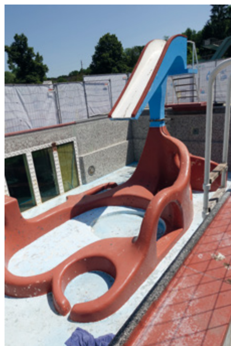
Der Tauchergarten in Steyr mit Betonplastik zum Durchtauchen muss aufwändig saniert werden.
