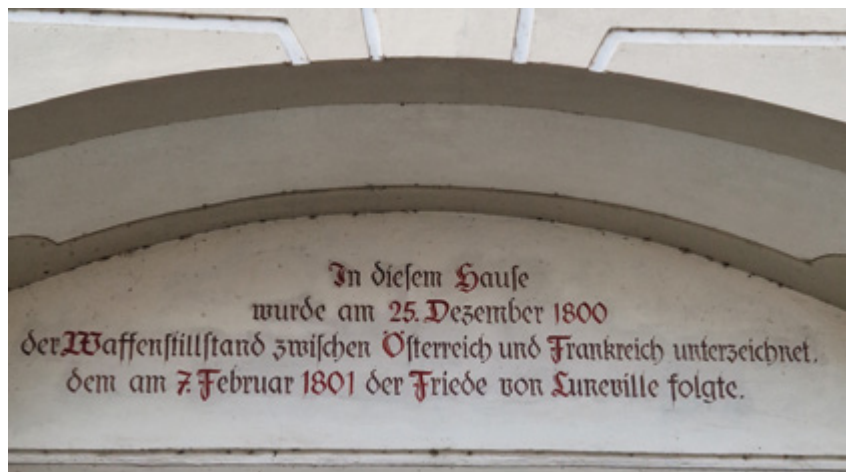
Die fehlerhafte Inschrift an der Fassade der Löwenapotheke © Hörmann ▼
