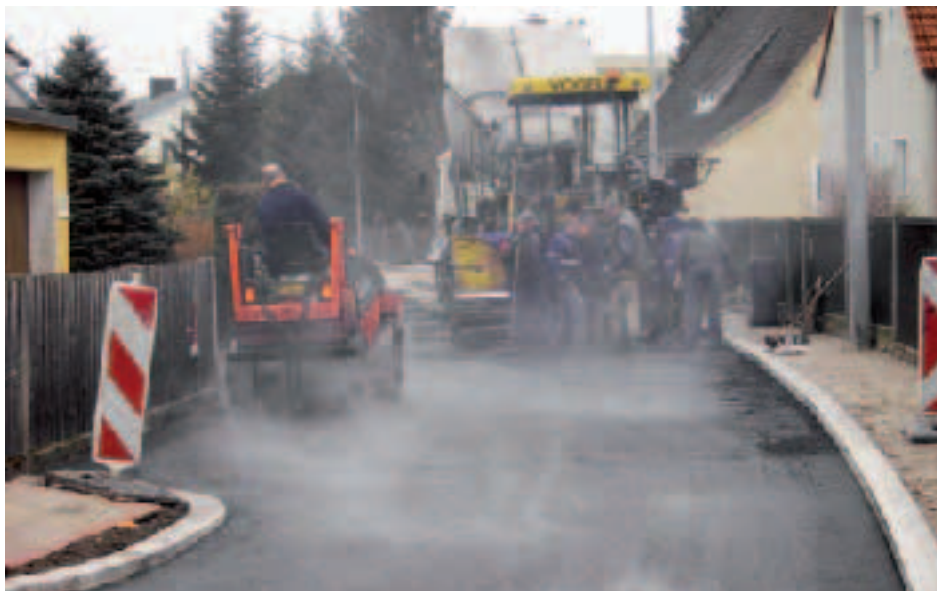
Das Kanalbau-Projekt im Bereich Reichenschwall, Neuluststraße und Sarninggasse ist fertig. Das Foto zeigt die abschließenden Asphaltierungsarbeiten.
