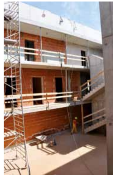
Blick in den Rohbau des neuen Hauses für Betreutes Wohnen auf der Ennsleite, unmittelbar neben dem neuen Alten- und Pflegeheim werden 30 Zweiraum-Wohnungen errichtet. Diese besondere Wohnform ist gedacht für Steyrer Seniorinnen und Senioren, die ihren Haushalt weitgehend selbständig führen können, aber trotzdem bei Bedarf jederzeit auf Hilfe zählen möchten.
