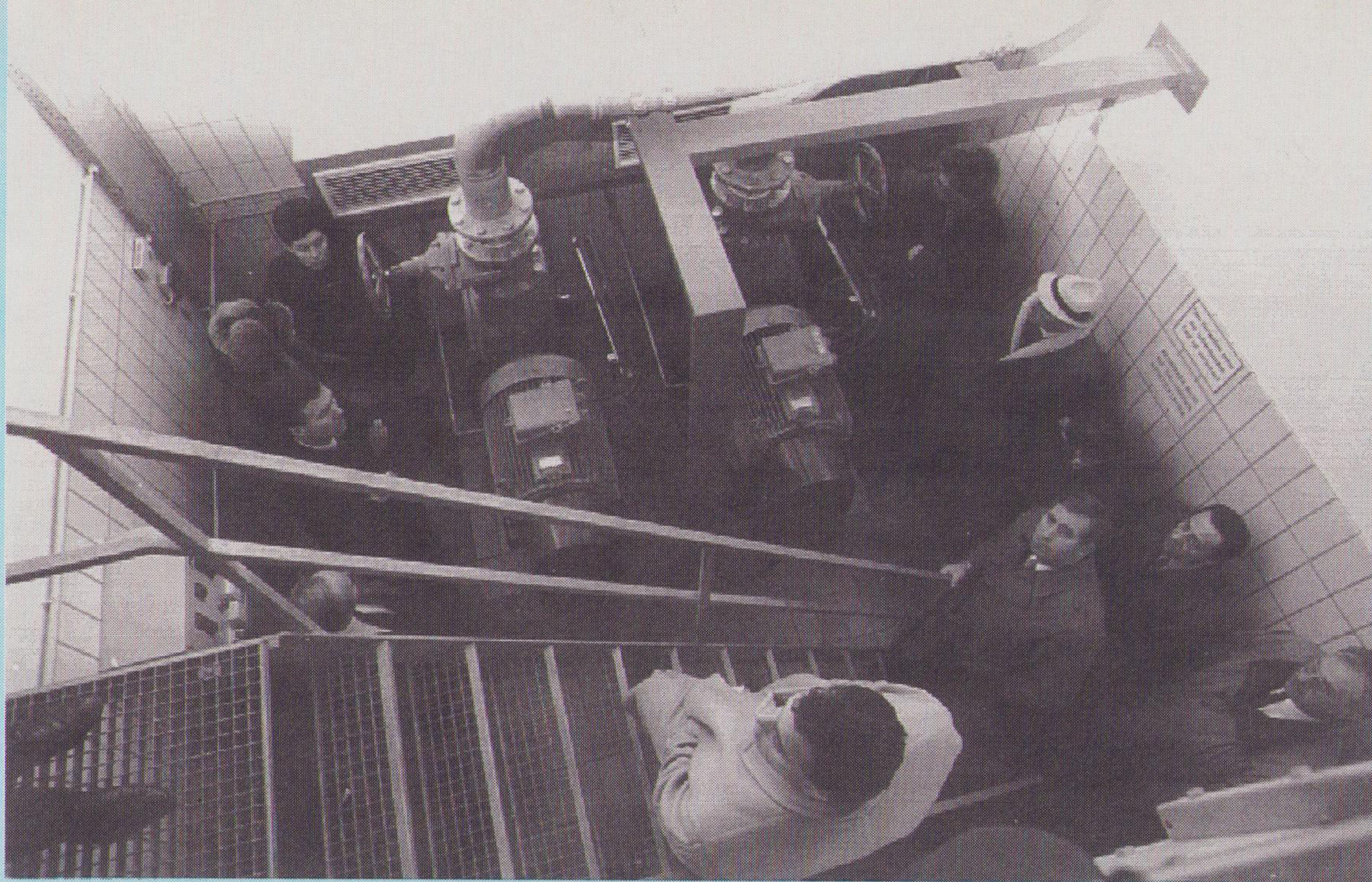
Blick in das Pumpwerk I in Sierning. Die Pumpen befördern die Abwässer aus den Gemeinden Sierning und Aschach über die 30 Meter hohe Terrasse auf die Höhe der Steyrtal-Bundesstraße, wo der Hauptsammler liegt.
