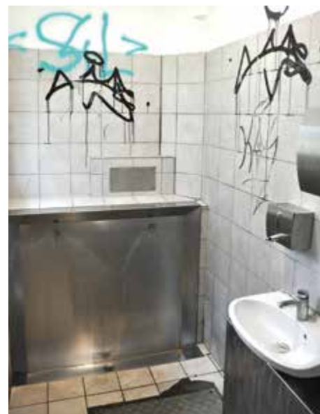
Das öffentliche WC im Münichholz ist durch Vandalismus oft kein guter Anblick. Hier wird an einer Lösung gearbeitet.
