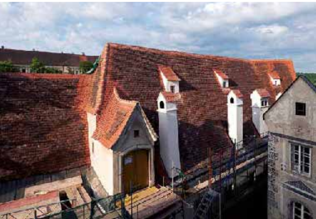
Straßenseitig sind die alten, noch gut erhaltenen Dachziegel aus Gründen des Denkmalschutzes wieder verwendet worden; an der Flusseite hat man alles neu eingedeckt.
