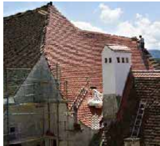
Zu den Bildern oben: Die Dachziegel am Grat und First sind nach alter Handwerkstradition in Mörtel verlegt worden.
