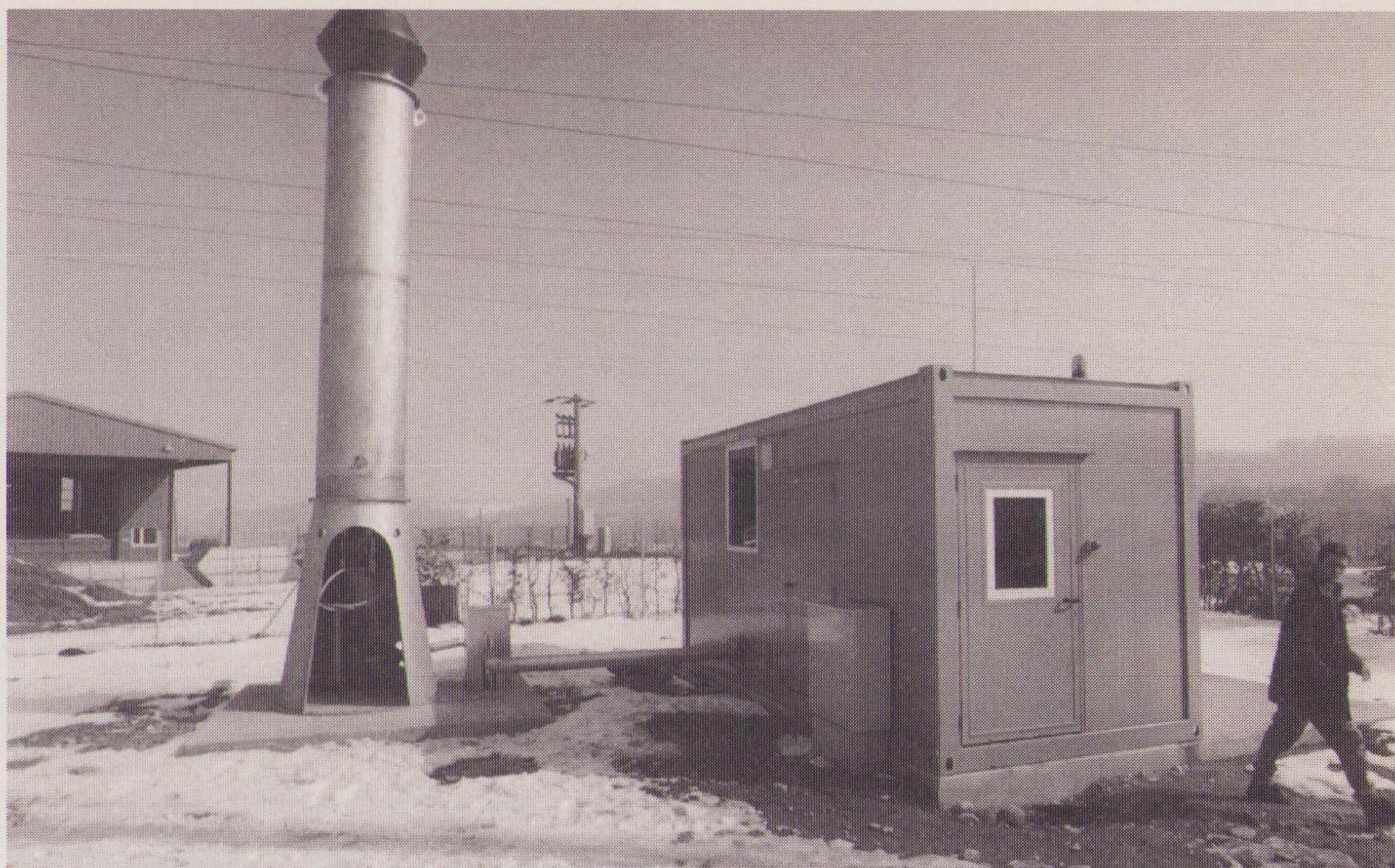
Links im Bild die 5 Meter hohe Muffelanlage, in der das Deponiegas verbrannt wird; rechts die computergesteuerte Verdichterstation.
