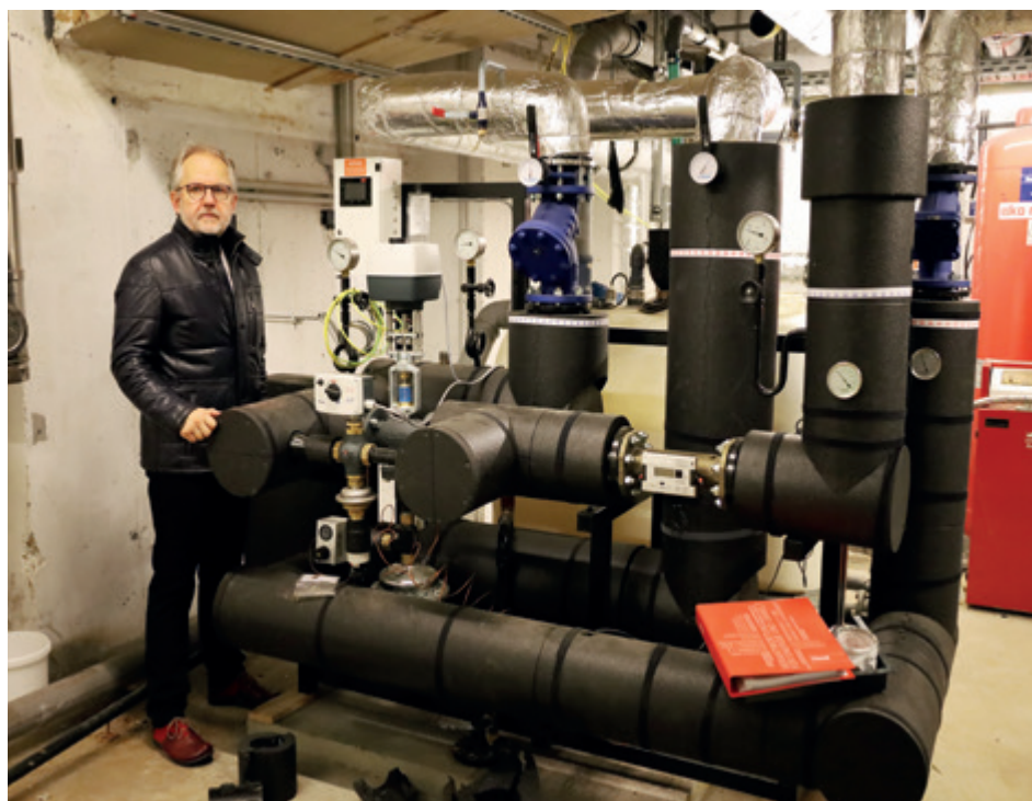
Das Alten- und Pflegeheim Münchenholz wird nun nicht mehr mit Gas geheizt, sondern hängt seit kurzem am Fernwärmenetz. Im Bild die neue Übergabestation im Keller des Altenheimes.
